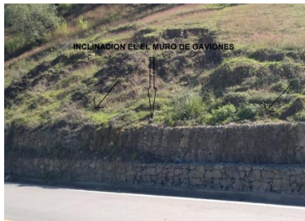
FIGURA. 49 Afectación a muro de gaviones.
