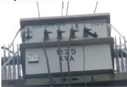
Figura 11. Especificación de potencia y voltaje secundario en un transformador.
