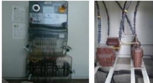
Figura 8. Verificación de sellos y estado de las conexiones en medida indirecta.
