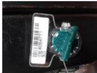
Figura 9. Sello de condensación en buen estado.
