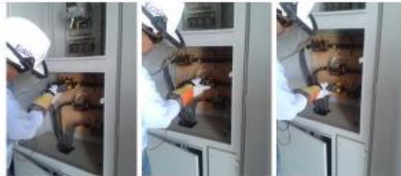
Figura 12. Verificación de corrientes en el transformador de corriente medida semidirecta.
