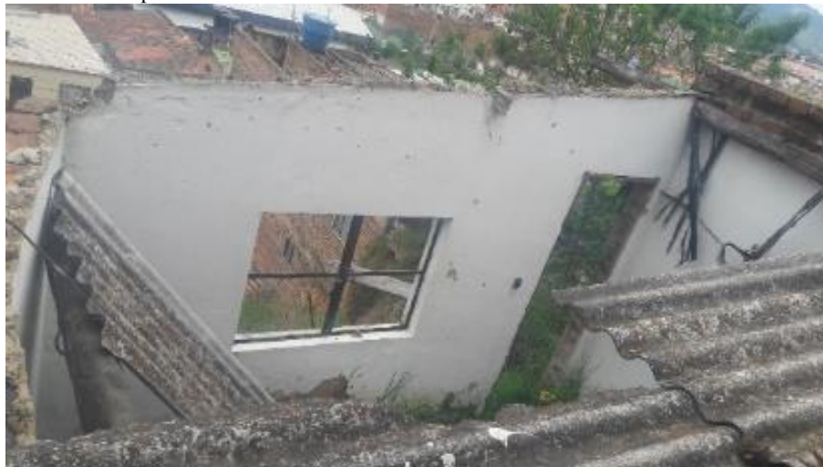
Figura 11. Vivienda abandonada por deslizamiento.
