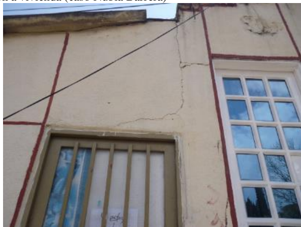
Figura 10. Evidencia afectación a vivienda (caso Nubia Barrera)
