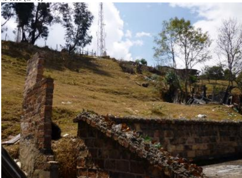
Figura 12 Muro contra la casa (LJ-T3)
