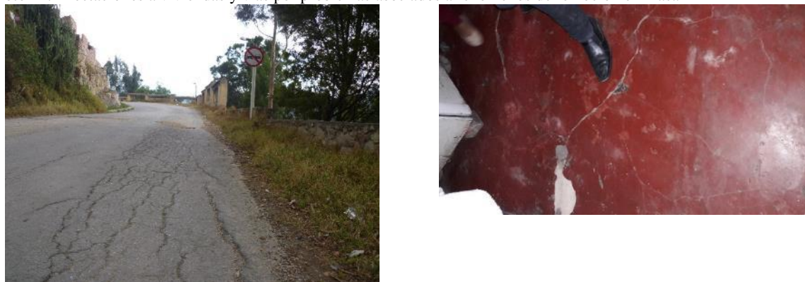
Foto 24. Afectaciones a viviendas y vías por problemas asociados a fenómenos de remoción en masa
