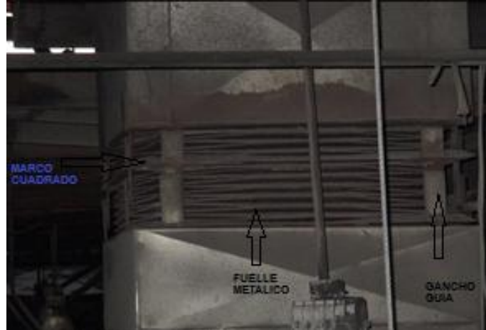
Figura 12. Junta de expansión deteriorada
