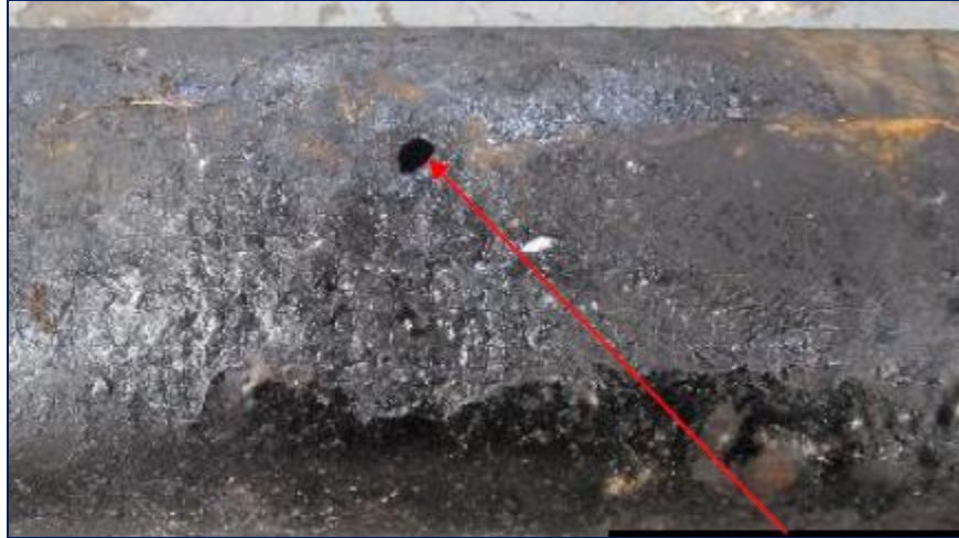
Imagen 5. Picadura en tubería de pozo CT 12.
