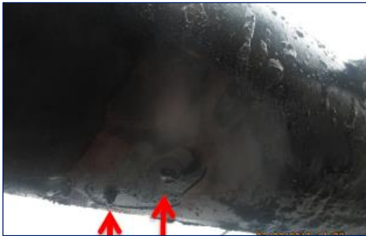
Imagen 6. Ampollamiento y Picadura en tubería de pozo CT 14.
