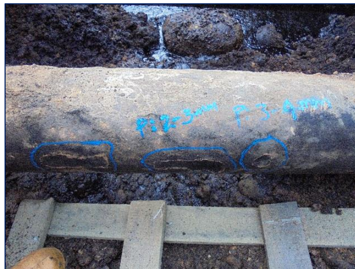
Imagen 4. Picadura en tubería de pozo CT 9.
