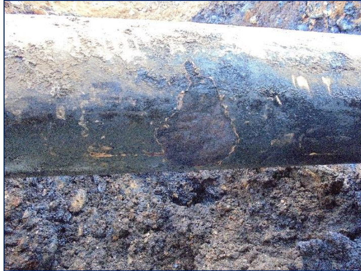
Imagen 3. Desprendimiento de Recubrimiento de pozo CT 3.
