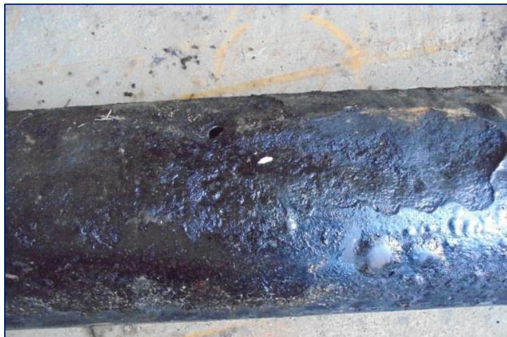
Imagen 1. Picadura en tubería de pozo CT 1.
