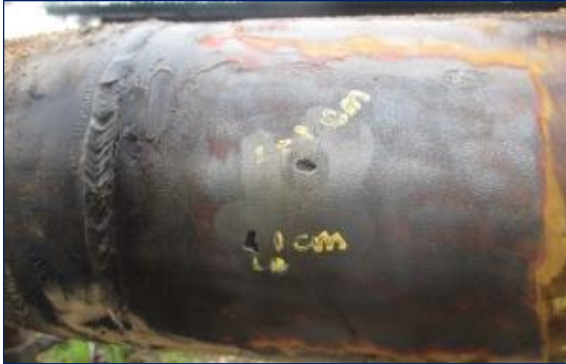
Imagen 7. Picadura en tubería de pozo CT 23.
