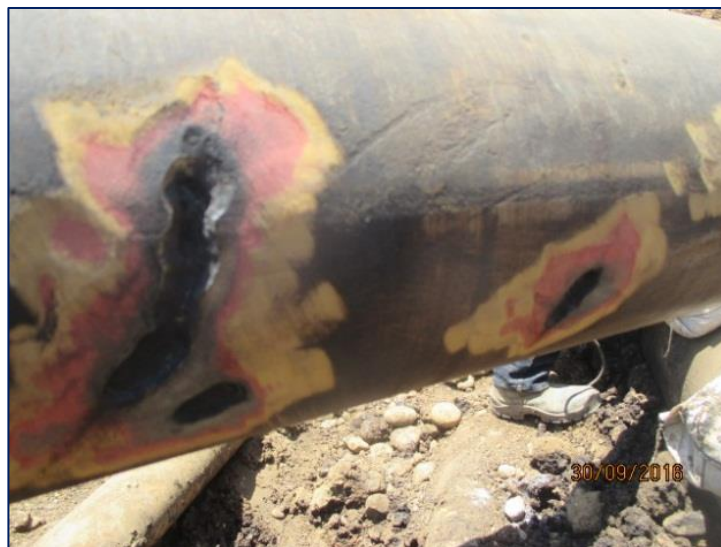
Imagen 2. Picadura en tubería de pozo CT 2.
