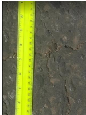
Figura 19. Fisuración de pavimento por fatiga
