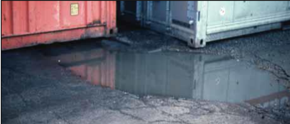
Figura 18. Falla de la losa de concreto en la región de las piezas metálicas de la esquina del contenedor (*).
