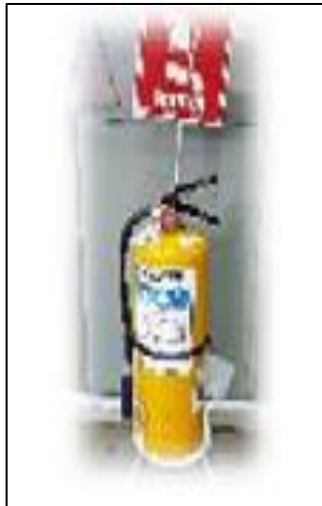
Figura 35. Sistema de extinción de incendios dentro del depósito de Archivos.
