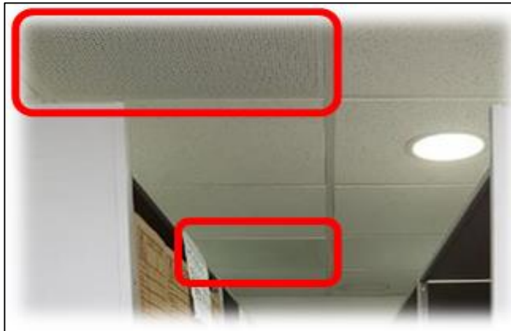
Figura 12. Detalle de las rendijas de ventilación interna del edificio
