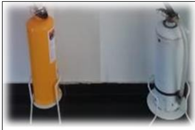
Figura 44. Extintores para el área de custodia de archivo de la Sede de Producción
