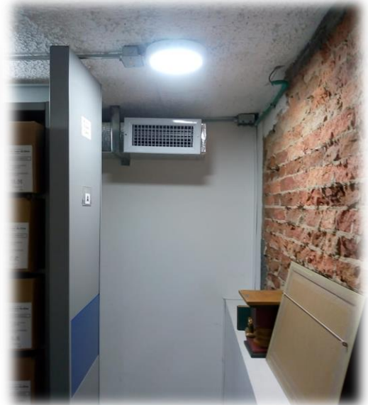
Fotografía No. 5 y 6. Detalle del sistema de ventilación al interior del depósito.
