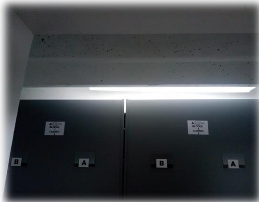
Fotografía No. 7. Detalle de la iluminación fluorescente al interior del depósito.
