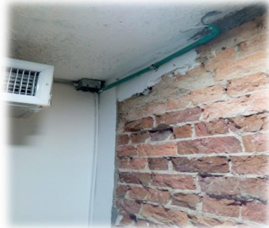
Fotografía No. 8. Detalle de las instalaciones eléctricas del depósito.
