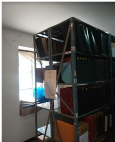
Foto 2. Estante frente a la ventana. Fisuras en la pared
