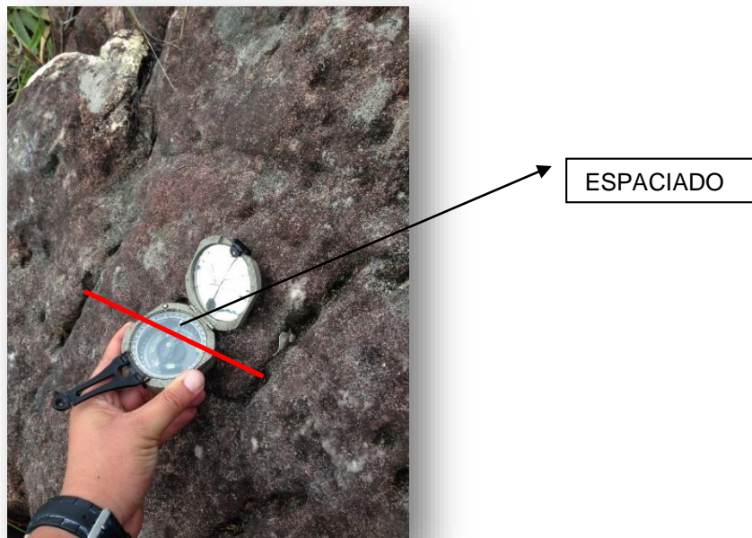
FOTO 11. Espaciado entre fisuras
