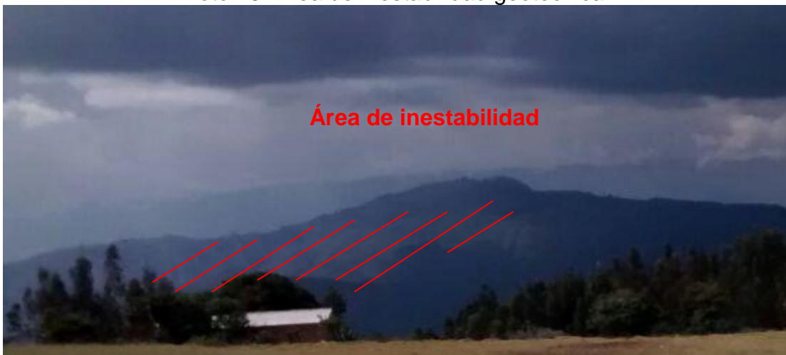
Foto 15. Área de inestabilidad geotécnica.
