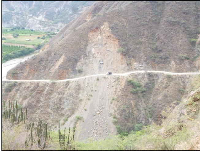
Fotografía No. 37. Deslizamiento sobre la vía
