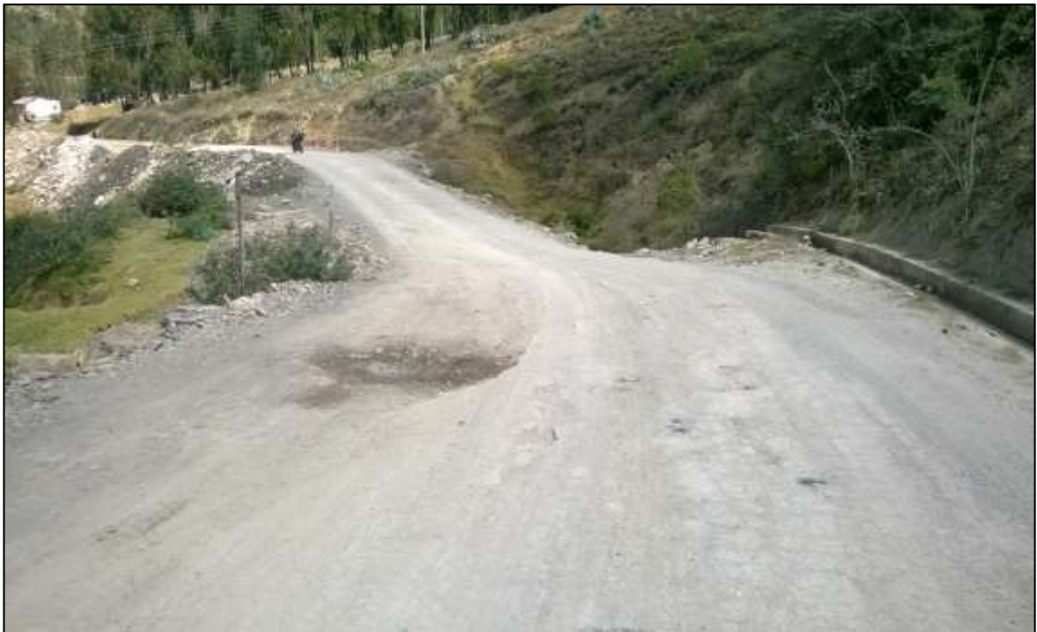
Fotografía 2 Hundimiento de la vía por la inestabilidad en el sector K4+180
