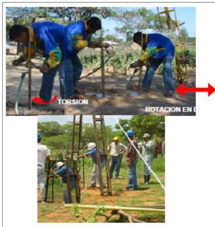
Figura 21. Movimiento de rotación: torsión y rotación en dos sentidos. Fuente: Guía RAS -007 Perforación Manual De Pozos Profundos De Pequeño Diámetro
