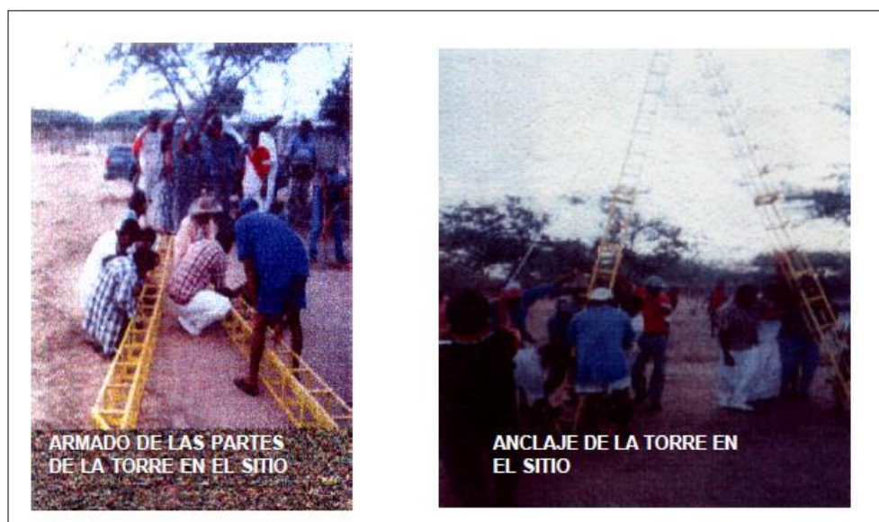
Figura 23. Montaje de la torre de perforación. Fuente: Guía RAS -007 Perforación Manual De Pozos Profundos De Pequeño Diámetro.
