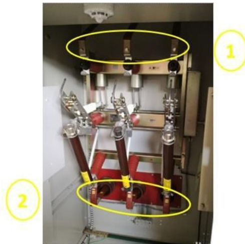
Figura 26. Celda de seccionamiento transformador de auxiliares.
