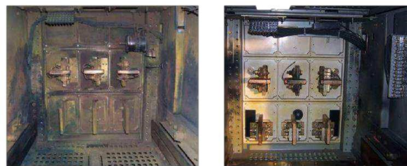
Figura 31. Comparación de consecuencias en equipos ante una falla de arco eléctrico despejada en diferentes tiempos.
