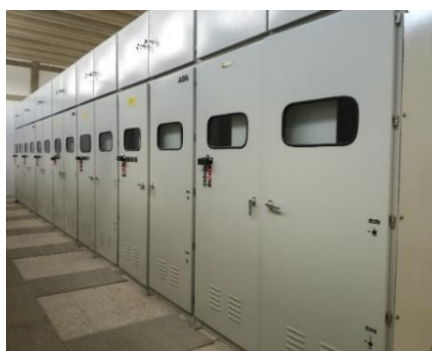
Figura 18. Tren de celdas 34.5 kV.
