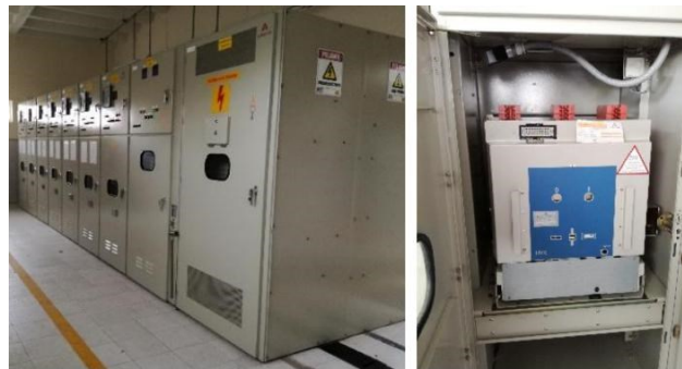
Figura 22. Tren de celdas 13.8 kV de la subestación Donato.
