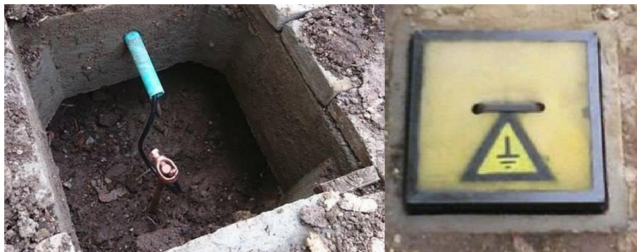
Figura 28. Sistema de puesta a tierra para la bobina de Tesla
