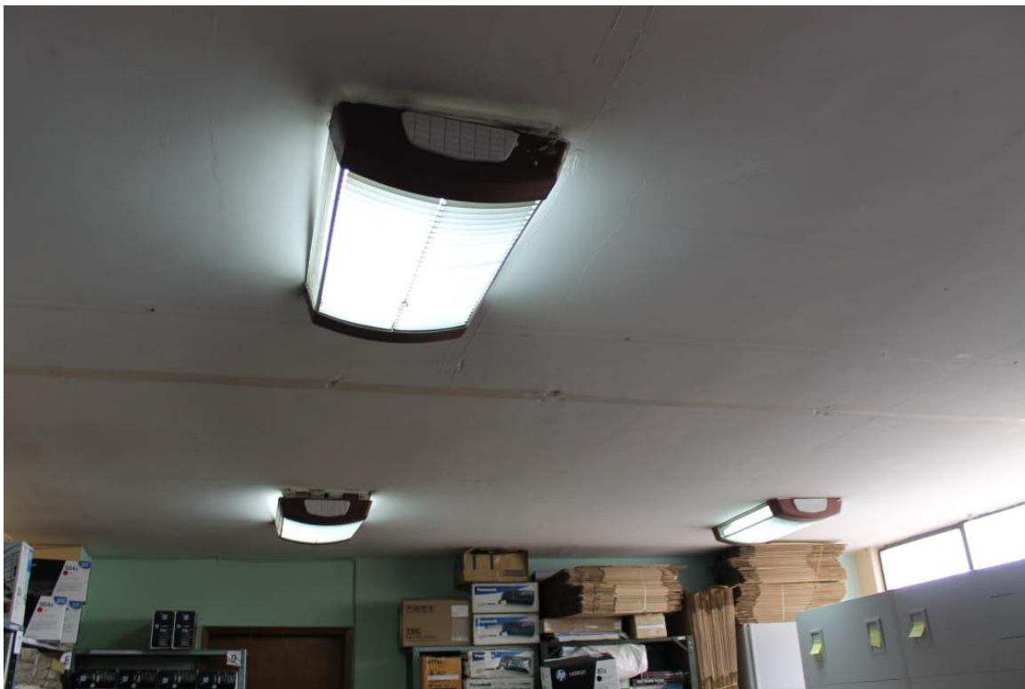
Figura 8. Evidencia de instalaciones eléctricas.
