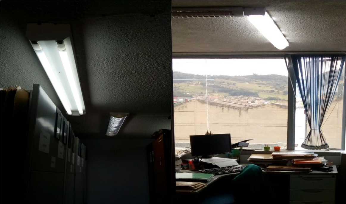
Foto No. 3 Iluminacion Bombillos en Balastro
