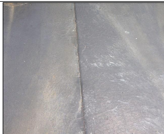
Foto 4. Agrietamientos del recubrimiento en techo.
