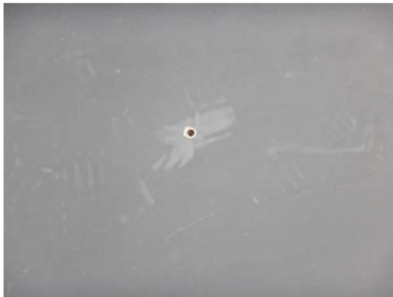
Foto 10. Corrosión pasante en el centro de la lámina, en la zona de vapores.
