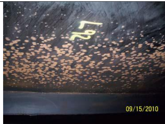
Foto 2. Corrosión en techo lado producto.
