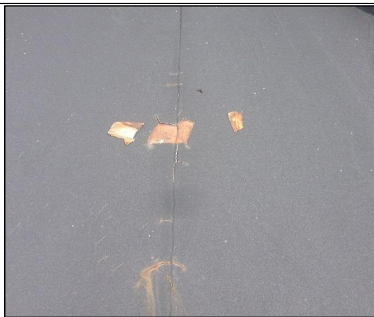
Foto 3. Agrietamientos y desprendimientos recubrimiento en techo.
