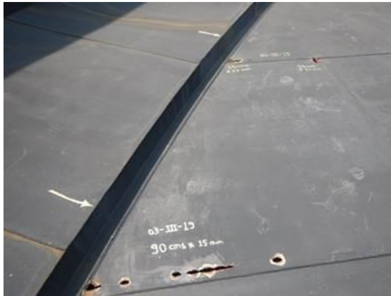
Foto 5. Vista general de las zonas afectadas.
