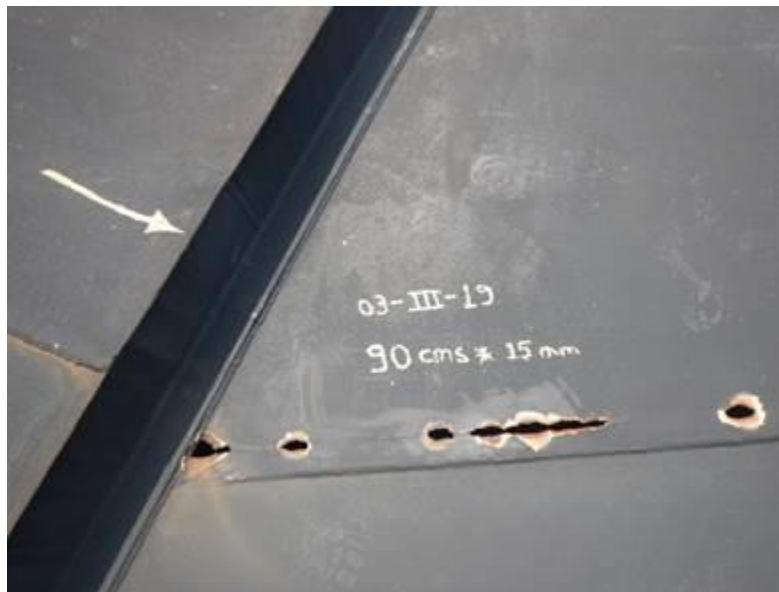
Foto 6. Corrosión pasante junto a la soldadura de traslape de las láminas.
