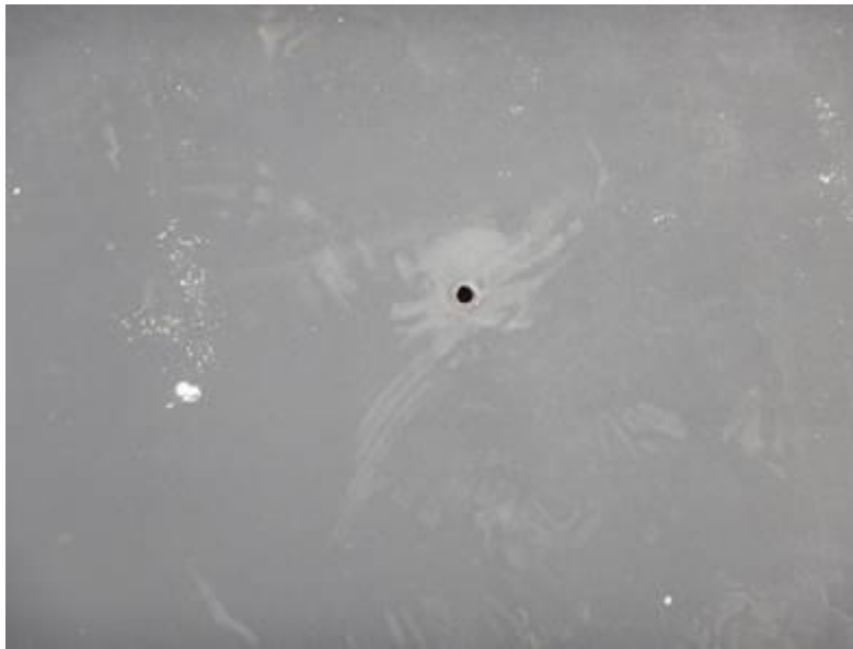
Foto 9. Corrosión pasante en el centro de la lámina, en la zona de vapores.
