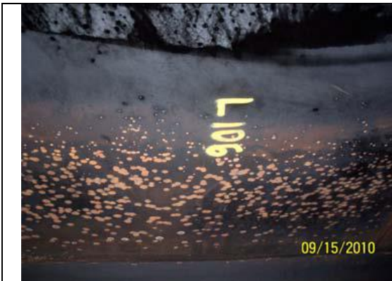
Foto 1. Corrosión en techo lado producto.
