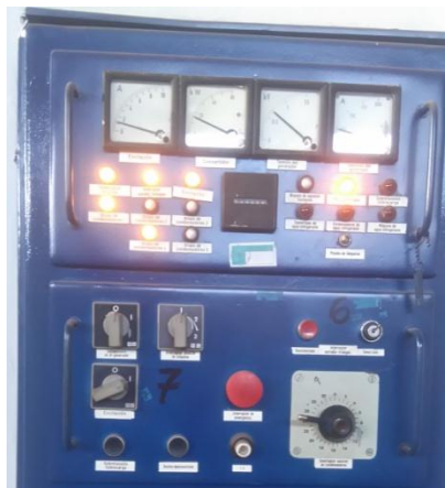
Figura 32. Panel principal Horno de inducción.
