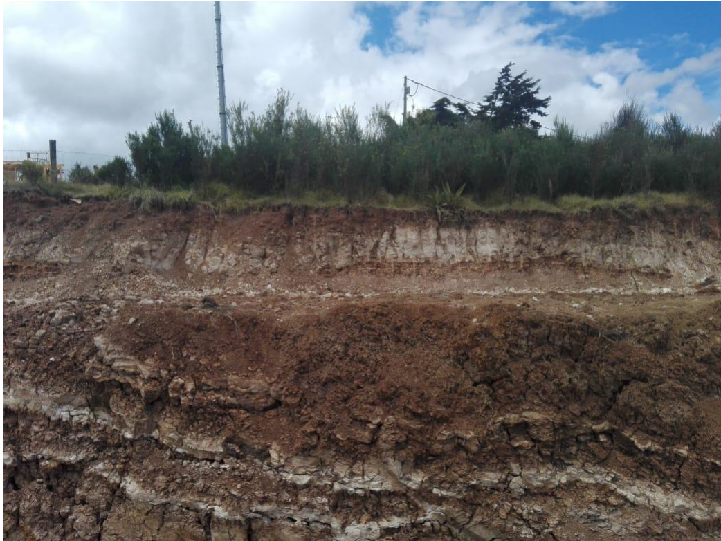
Figura 42 Talud de corte con exposición de capas con contenido de Diatomita. Fuente. Propia
