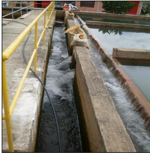
Imagen 12. Canal de repartición de caudal hacia los filtros
