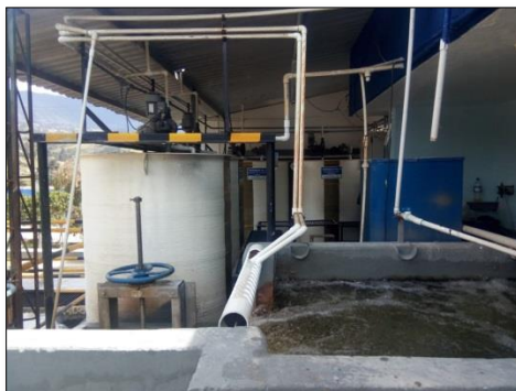
Imagen 5. Cámara de llegada de agua cruda
