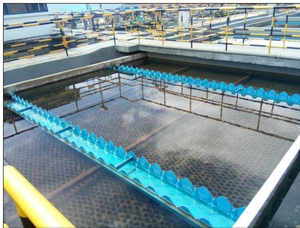
Imagen 11. Sedimentadores de la planta de tratamiento
