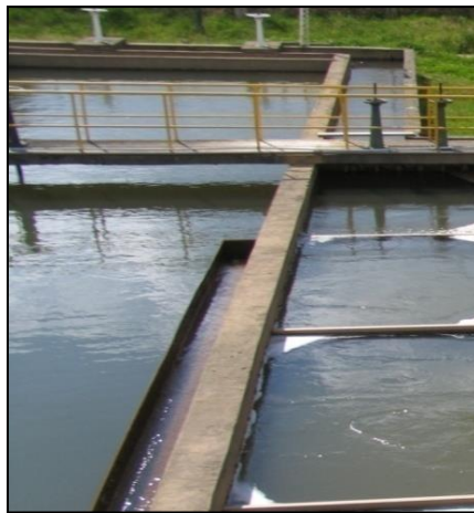
Imagen 10. Canal de aquietamiento de la planta
