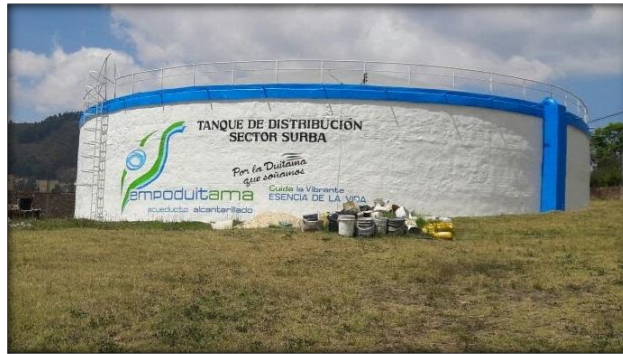
Imagen 15. Tanque de almacenamiento del sistema Surba
