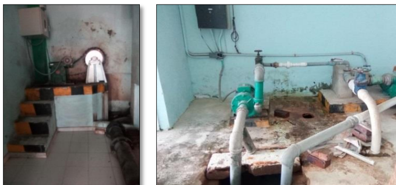
Imagen 19. Cuarto de Maquinas
