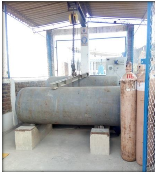
Imagen 14. Área de cloración de la planta
