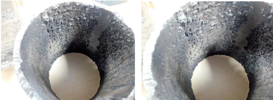
Ilustración 19. Evidencia de la formación de Pitting por presencia de CO 2
