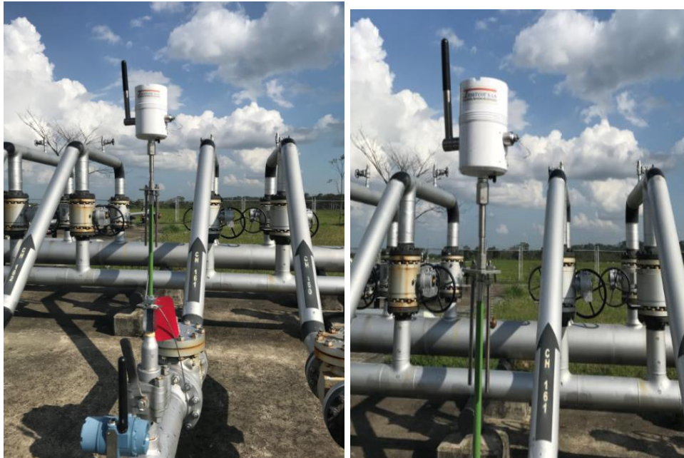
Ilustración 24. Instalación de probetas Microcorr Wireless
