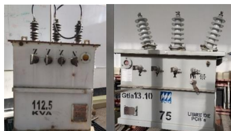
Figura 5 Transformador bajo ensayo de 112,5 kVA y 75 kVA disponibles en el laboratorio de ensayos electromecánicos
