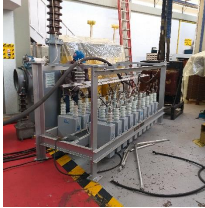
Figura 1 Banco de condensadores empleado para desarrollar el ensayo
