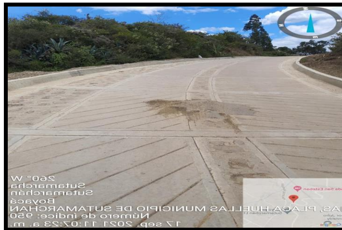
Figura 11. Acumulación de materiales sobre la calzada
