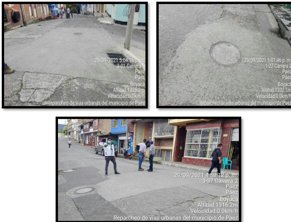
Figura 3. Reparcho de vías urbanas del municipio de Páez.
