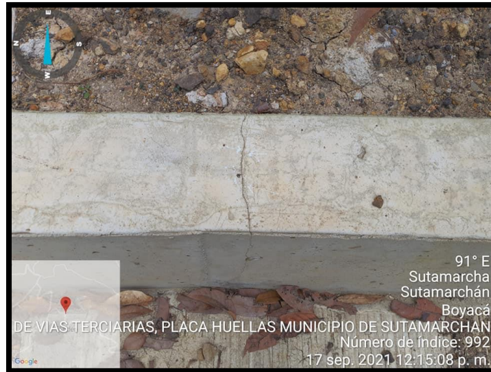
Figura 10. Fisuras en bordillos.
