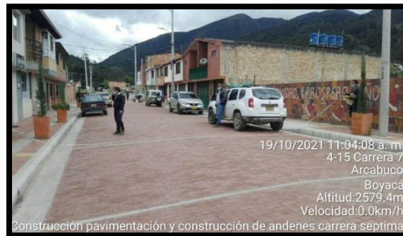
Figura 7. Estado actual pavimentación y andenes carrera 7 entre calle 4 y vía nacional.
