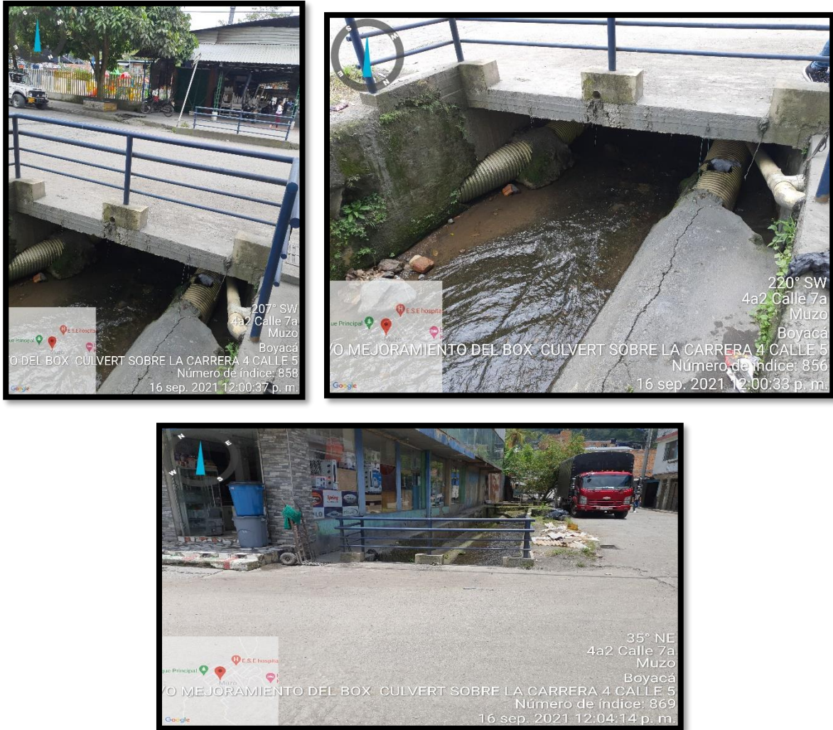
Figura 8. Box culvert placa en concreto simple de 21 Mpa, barandas en tubería metálica agua negra d=2". c. 0. 80.
