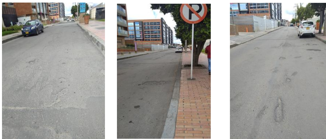
Figura 100. Daños en el pavimento más frecuentes en el sector
