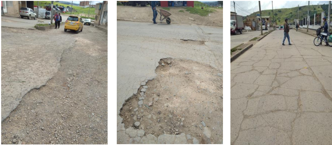
Figura 32. Daños en el pavimento más frecuentes en el tramo de estudio
