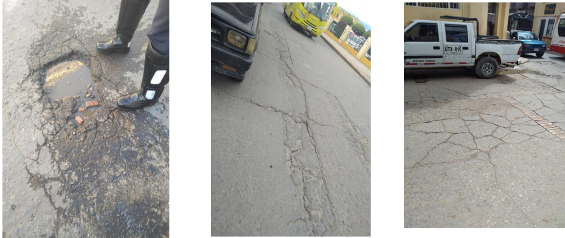
Figura 8. Daños en pavimento más representativos sobre la carrera 14
