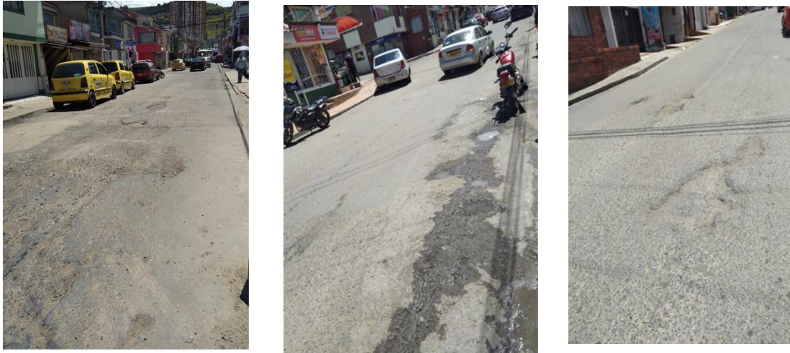
Figura 84. Daños representativos del pavimento
