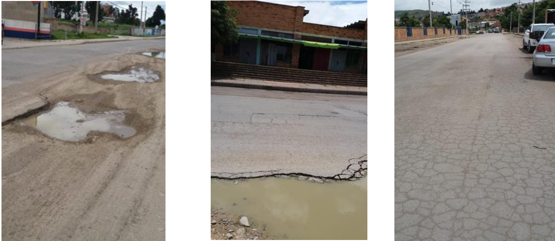
Figura 48. Daños más recurrentes en el sector plaza del norte
