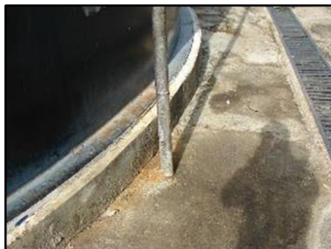
Figura 14. Tk. Bolívar. Pestaña y tubería externa.
