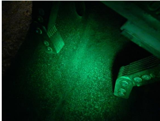
Resultado de MT fluorescentes en soldadura del cámara trasera del tubo hogar
