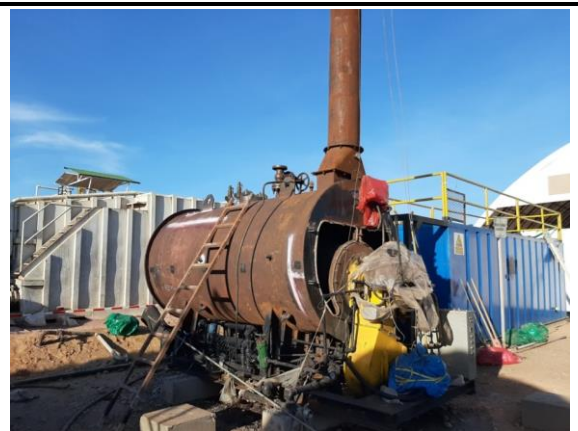
Sectores inspeccionados por PT en el lado occidental de la caldera de vapor
