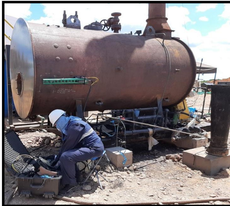
Ilustración 16. Sector inspeccionado mediante mapeo de corrosión - UT Scan C
