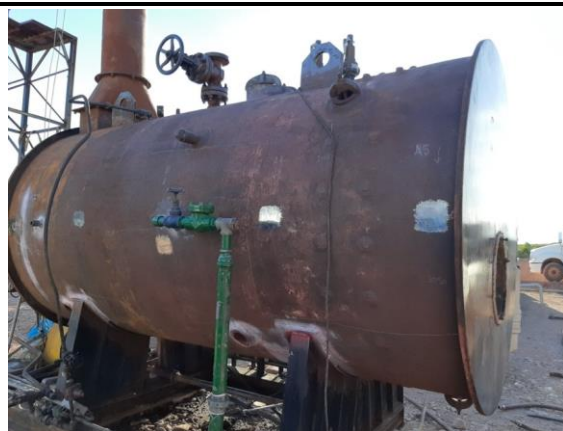
Sectores inspeccionados por PT en el lado oriental de la caldera de vapor
