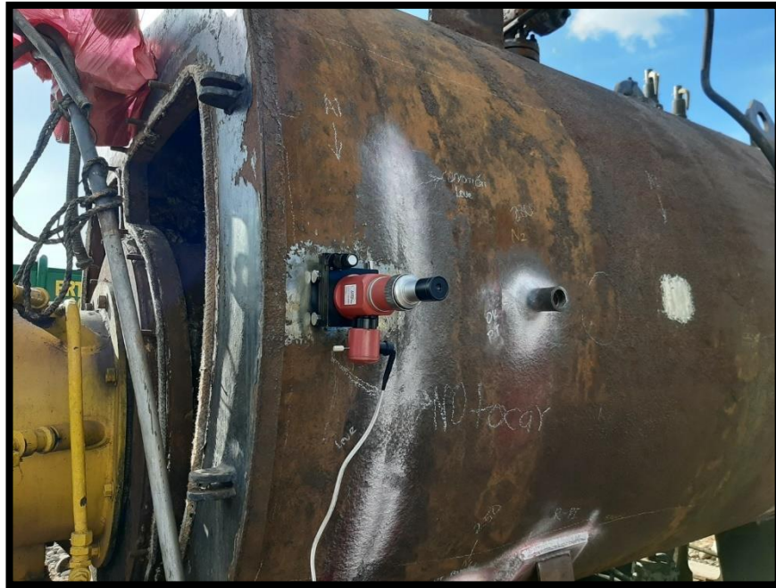
Ilustración 13. Ubicación #1 metalografía In Situ en cuerpo de la caldera
