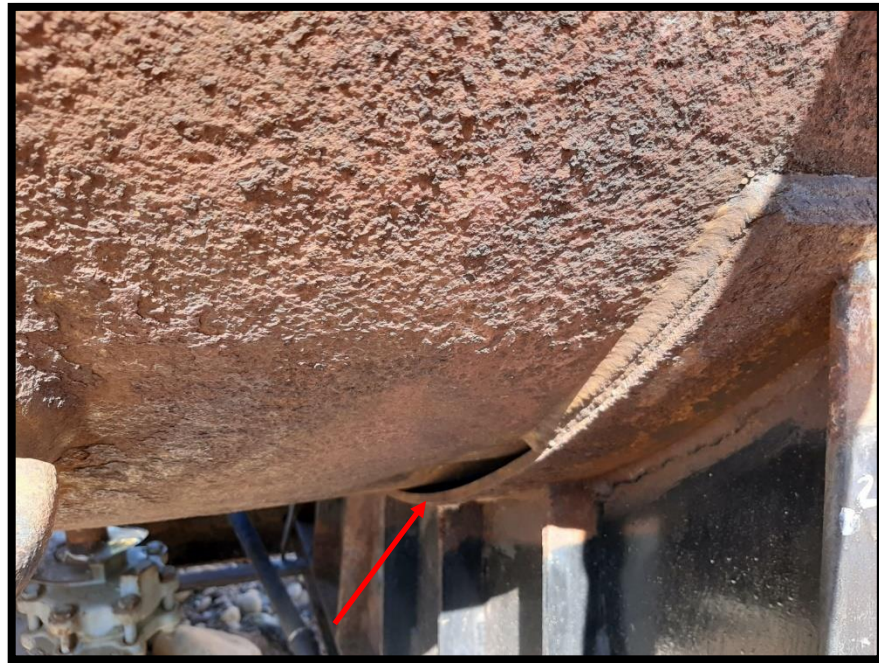
Ilustración 8. Sector con daño mecánico severo tipo abolladura combinado con CUI en el cuerpo de la caldera.
