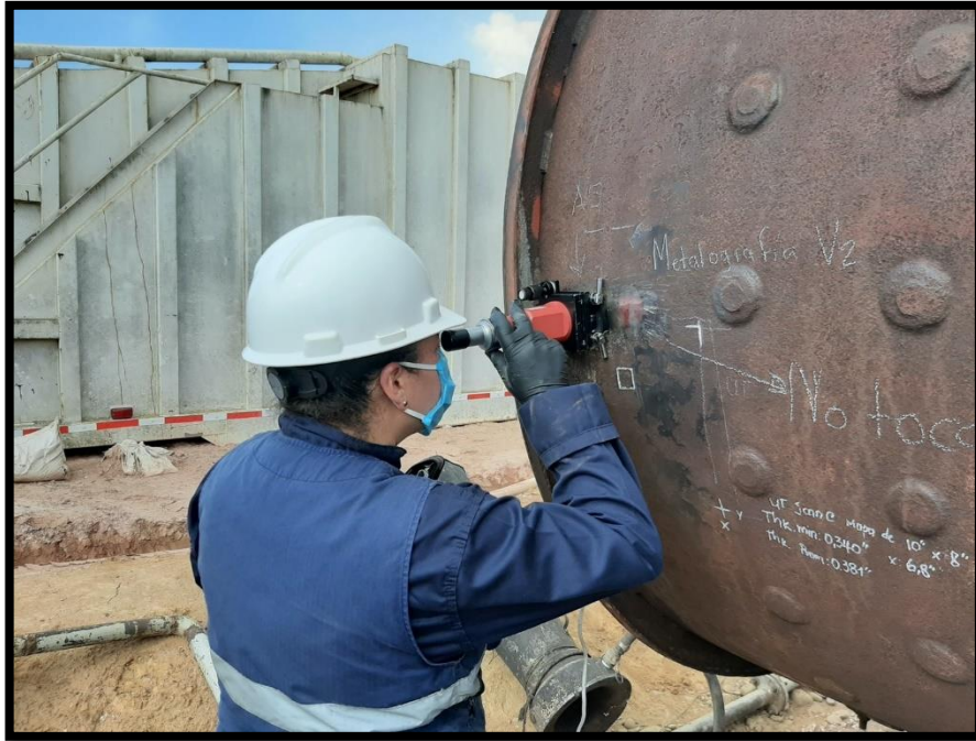
Ilustración 14. Ubicación #2 metalografía In Situ en cuerpo de la caldera
