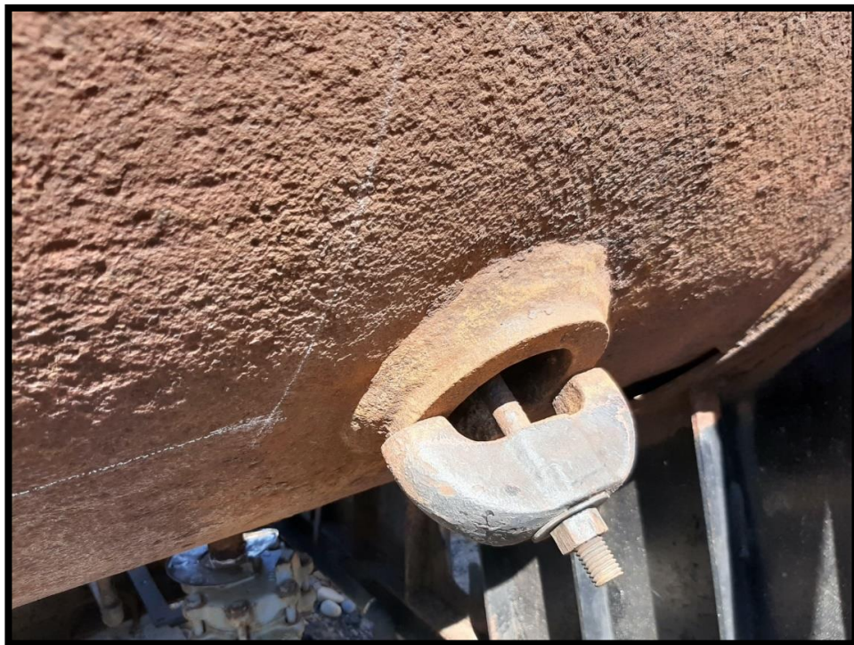
Ilustración 7. Condición de la superficie externa del cuerpo de la caldera por CUI
