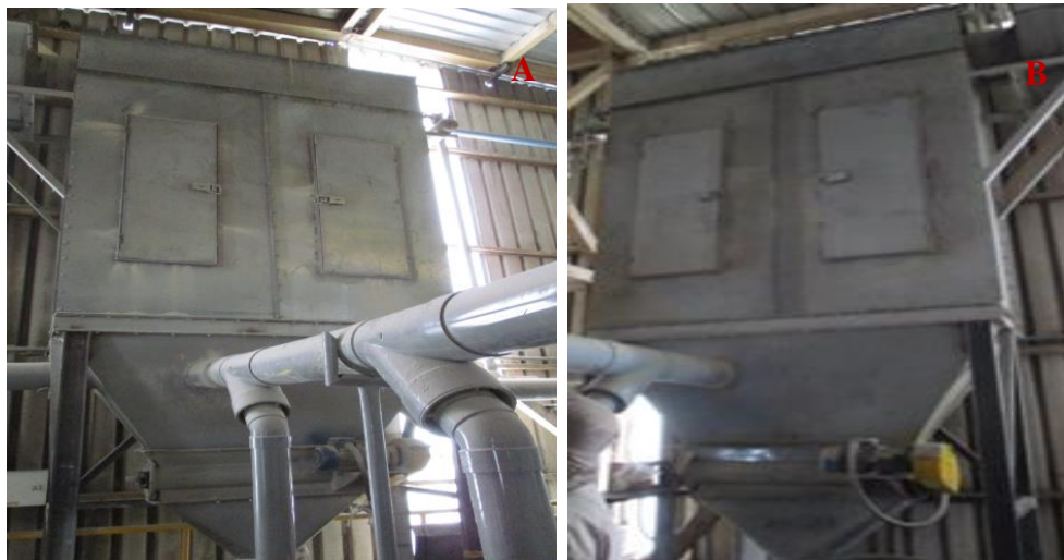
Figura 26. Filtro de mangas premolienda y Dosificación
