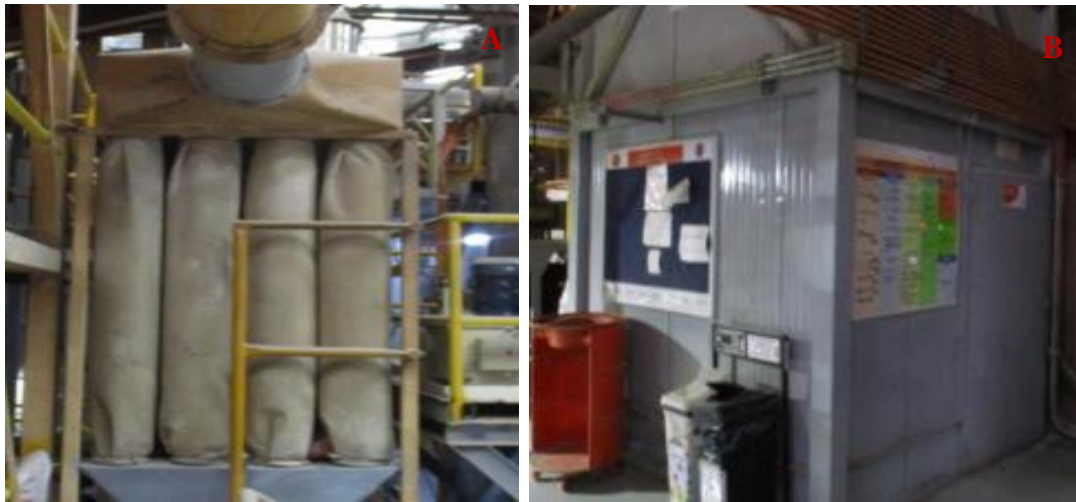
Figura 38. Filtro de mangas molino y cabina insonora molino
