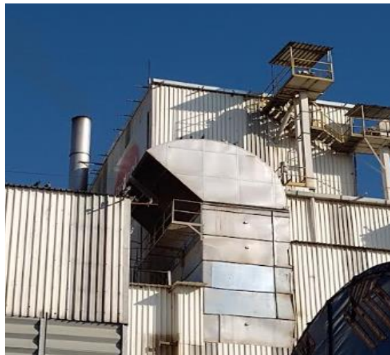
Figura 29. Plenum Área peletizado
