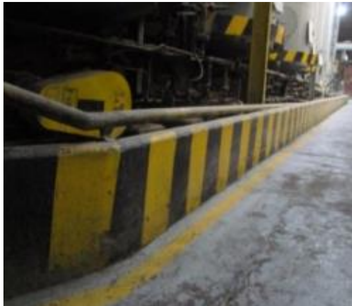
Figura 21. Dique de contención área almacenamiento de líquidos
