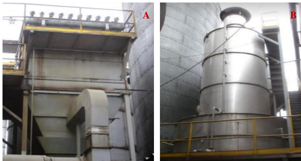
Figura 39. Filtro de mangas y lavador de gases
