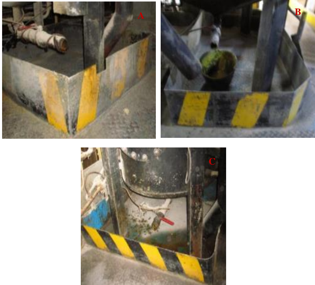
Figura 23. Diques de contención área post engrase
