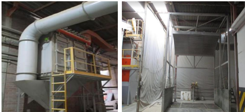
Figura 35. Filtro de mangas, encerramiento y cabina de extracción vaceo
