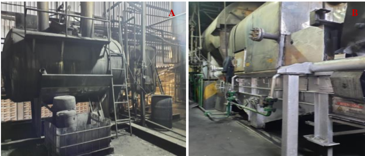
Figura 13. Área de la caldera
