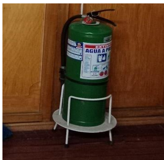
Fotografía 17. Extintor tipo A.
