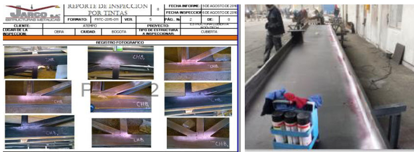
Figura 16. Pruebas de líquidos penetrantes. En la imagen se muestra pruebas realizadas a las soldaduras, adicionalmente informe que se debe presentar sobre las mismas. Fuente, autor.
