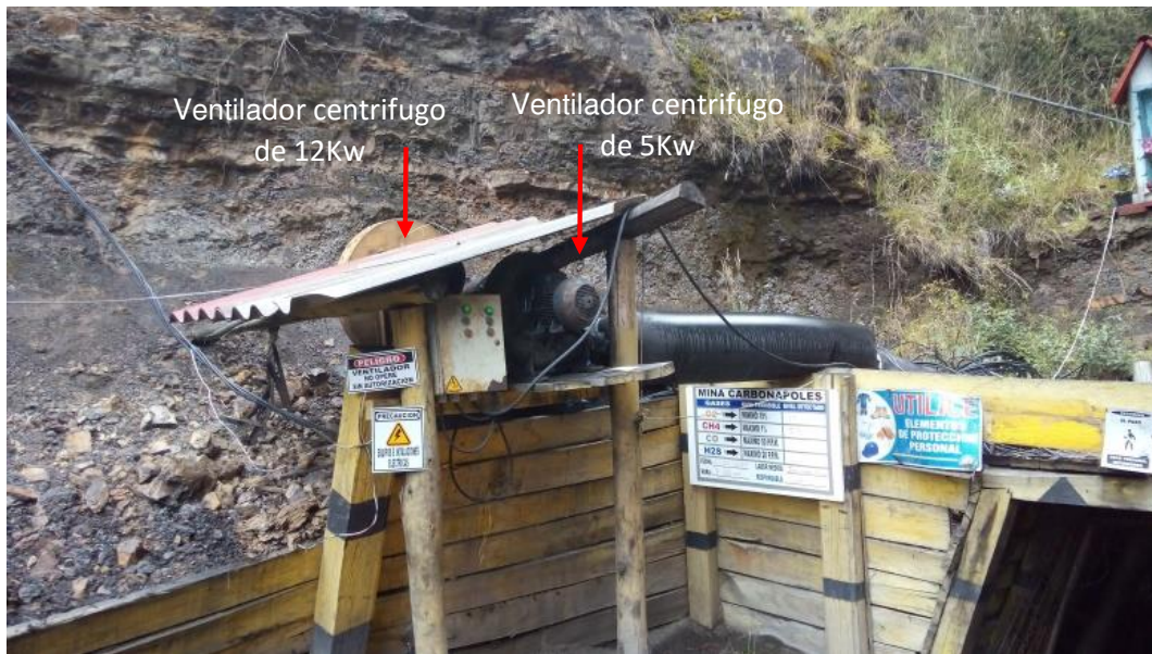
Figura 2. Ventiladores centrífugos de 12 Kw y 5 Kw, en bocamina
