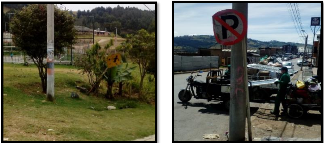
Figura 29. Señalización Vertical (Zona deportiva y Prohibido parquear) en mal estado.
