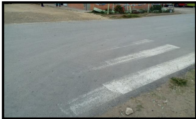
Figura 24. Señal Horizontal (Cebra) en mal estado
