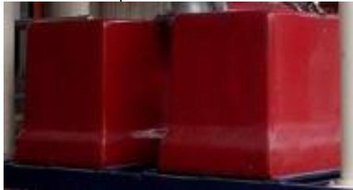
Figura 22. Condensadores de etapa.
