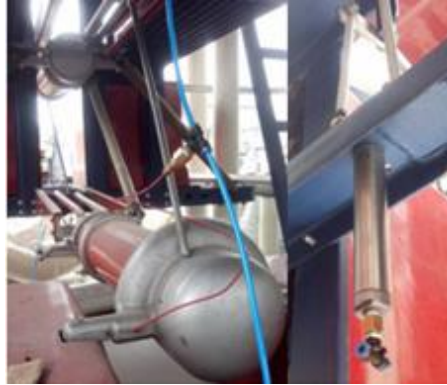
Figura 27. (a) Sistema de puesta a tierra neumático.
