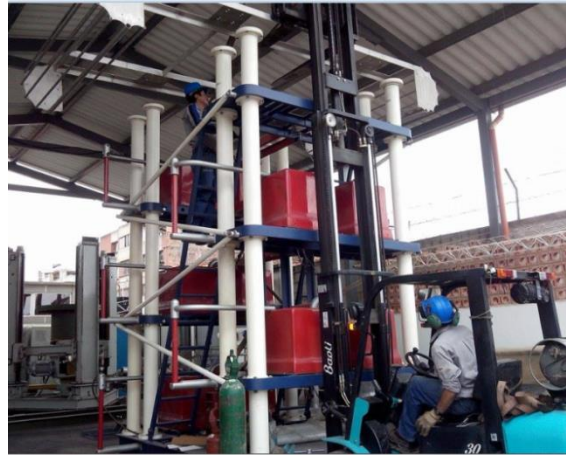
Figura 38. Ensamble del generador de impulso de tensión.
