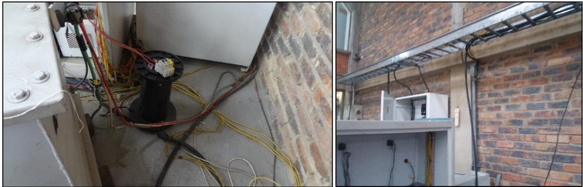
Figura 23. Cableado de potencia campo de pruebas C.M.E.
