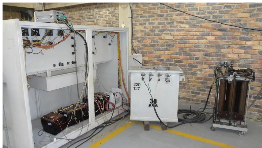
Figura 19. Transformador intermedio campo de pruebas C.M.E.
