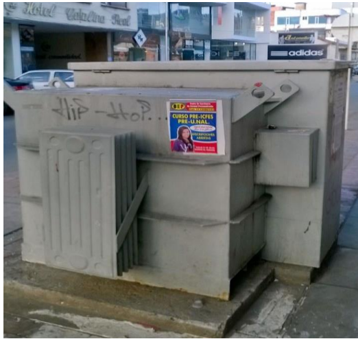
Figura 7. Subestación Pedestal, Duitama-centro, media tensión.
