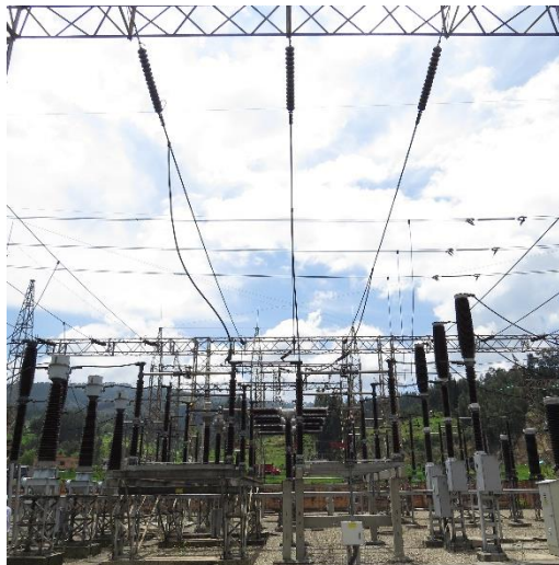
Figura 8. Equipos de patio, subestación Termopaipa, anillo 220 kV.
