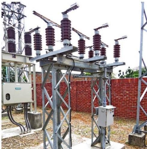
Figura 52. Seccionador de barra con una sola columna giratoria y doble interrupción, en posición abierto. Subestación Puerto Boyacá
