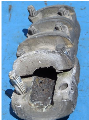
Figura 69. Deterioro de conectores
