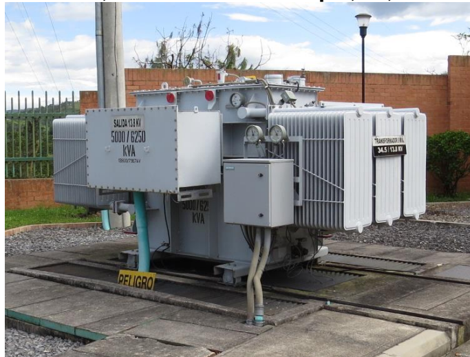
Figura 9. Transformador, subestación Guateque, 34,5 kV – 13,8 kV
