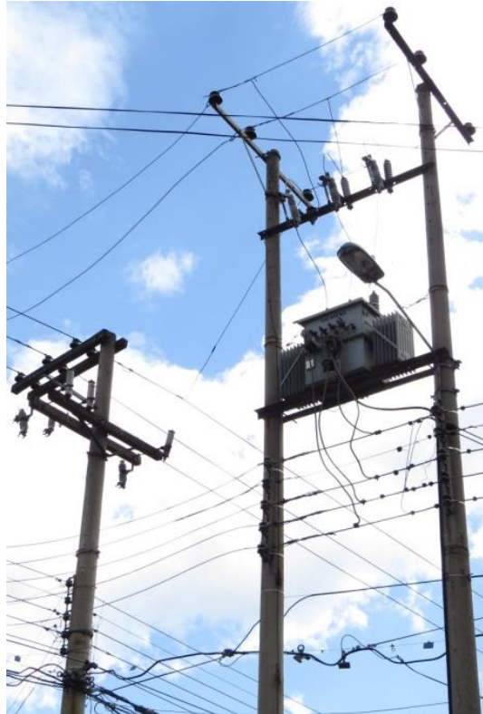
Figura 2. Subestación aérea, Duitama, tipo poste media tensión.
