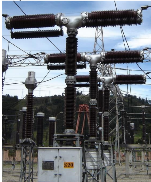
Figura 12. Interruptor de potencia, subestación Termopaipa, anillo 220 kV
