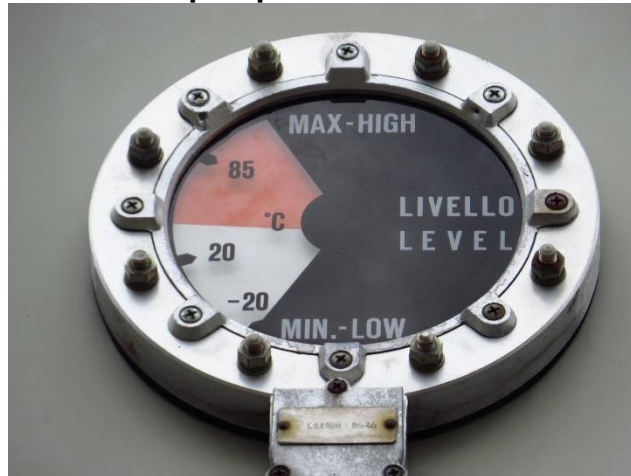
Figura 37. Indicadores de nivel de aceite. Transformador tridevanado. Subestación Chiquinquirá.
