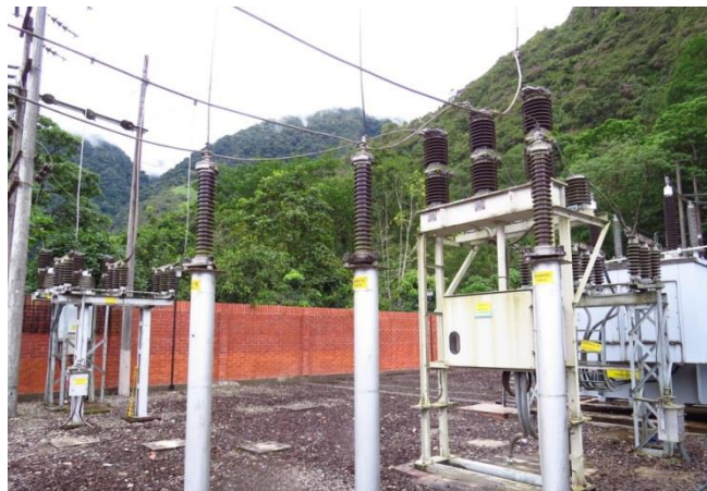
Figura 5. Subestación Santa María, tipo patio, bahía media tensión.
