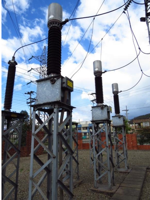
Figura 48. Transformador de potencial para 115 kV. Subestación La Ramada
