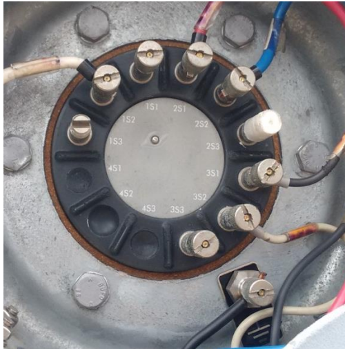
Figura 51. Bornes de conexión secundarios de un transformador de corriente
