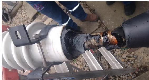
Figura 25. Daños de aislamiento XLPE debido al envejecimiento, cristalización de cable XLPE, subestación termopaipa.
