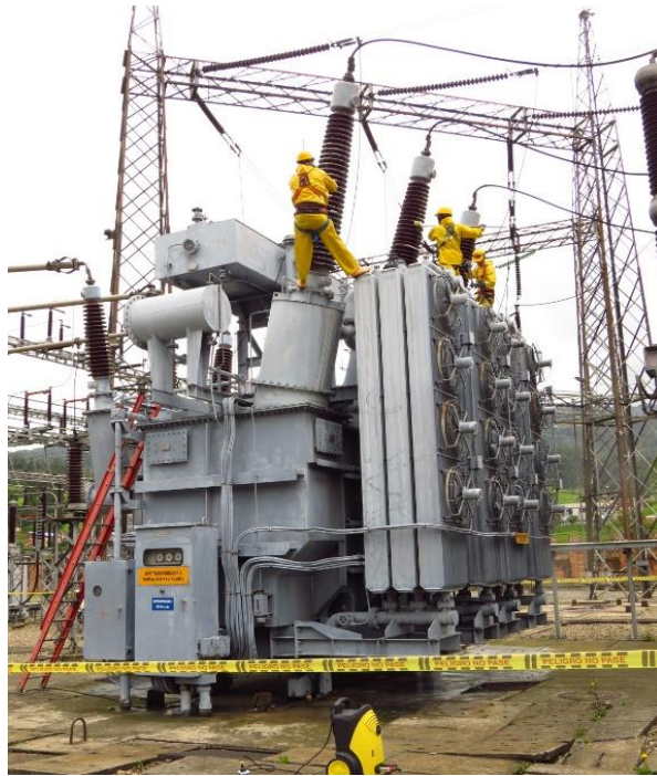
Figura 10. Mantenimiento al autotransformador 2, subestación Termopaipa, anillo 220 kV
