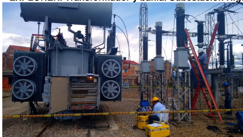
Figura 39. Pruebas eléctricas realizadas por personal de la EBSA y EXPLORER. Transformador y bahía. Subestación Higuerras.
