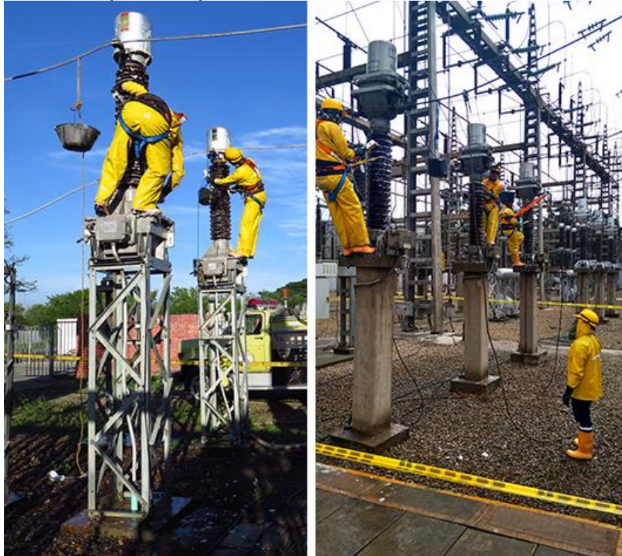
Figura 49. Limpieza a PTs (izquierda). Subestación Puerto Boyacá. Limpieza a CTs (derecha). Subestación San Antonio.
