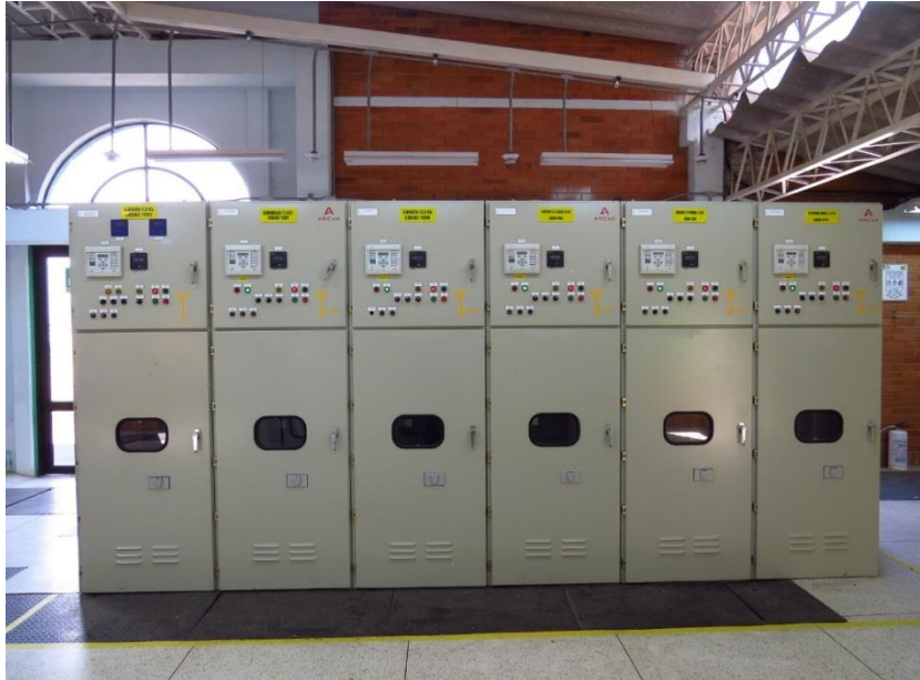
Figura 18. Celdas o gabinetes, subestación Guateque.
