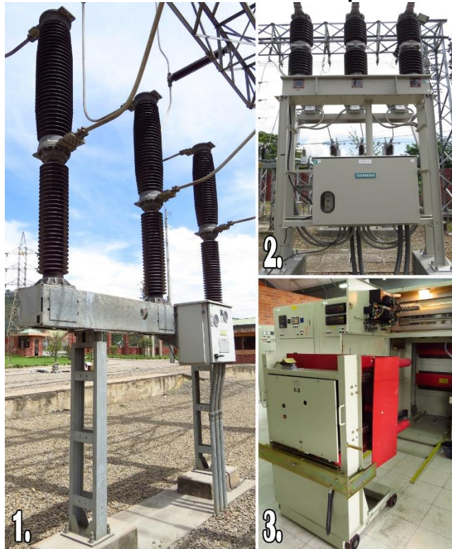
Figura 13. Algunos de los equipos con los que cuentan las subestaciones de la EBSA E.S.P. en cuanto a Interruptores se refieren
