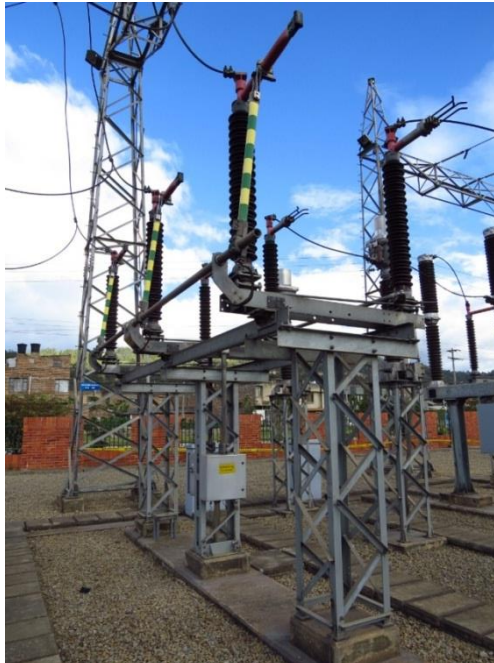
Figura 53. Seccionador de línea con doble columna giratoria y una sola interrupción, en posición abierto aterrizado. Subestación La Ramada
