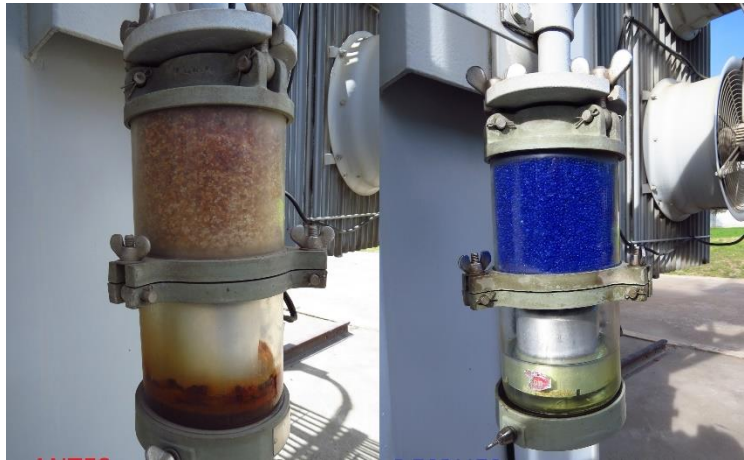
Figura 35. Mantenimiento al respiradero deshidratador. Cambio de sílica gel. Desgastada (izquierda), nueva (derecha). Subestación San Antonio
