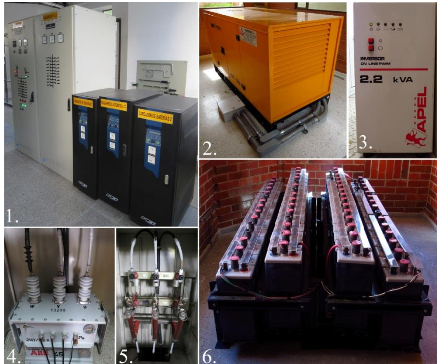
1. Celdas de distribución de CD – AC y Cargador de baterías. 2. Grupo electrógeno o Planta de emergencia. 3. Inversor. 4. Transformador de auxiliares. 5. Seccionador de auxiliares. 6. Banco de baterías.
