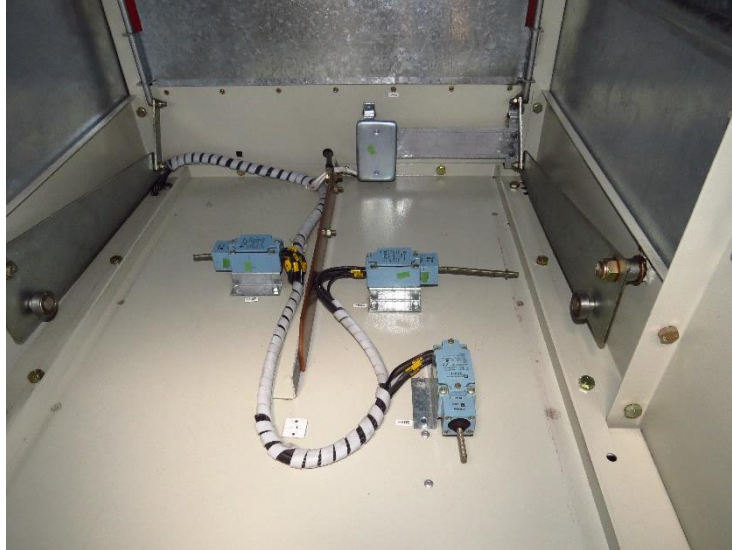
Figura 60. Compartimiento del interruptor en celda de 13,8 kV.
