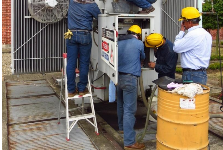
Figura 34. Limpieza a la caja de control del transformador. Subestación Iraka
