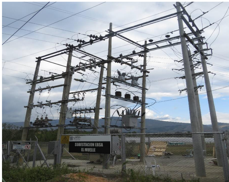
Figura 3. Subestación El muelle, Villa de Leyva, tipo poste media tensión.
