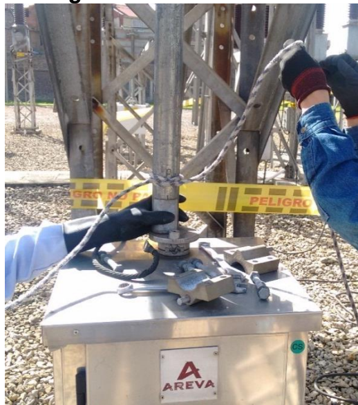
Figura 54. Seccionador desacoplado con el mando del mecanismo. Subestación Higueras.
