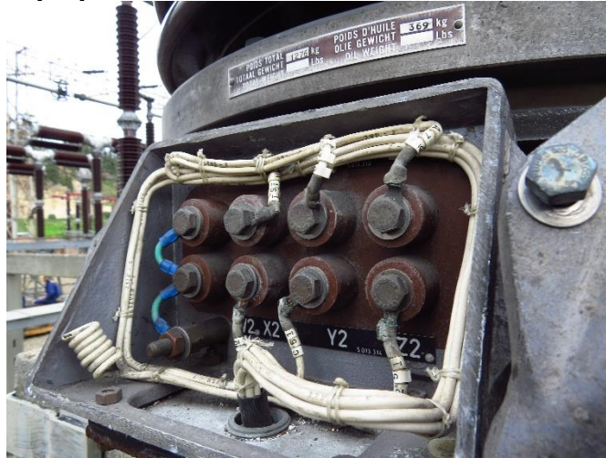
Figura 46. Bornes de un transformador de corriente de 220 kV. Subestación Termopaipa.
