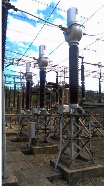
Figura 47. Transformador de corriente para 220 kV. Subestación Termopaipa
