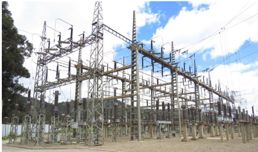
Figura 4. Subestación San Antonio, Sogamoso, tipo patio alta tensión.
