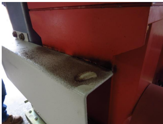
Figura 75. Falla de aislamiento
