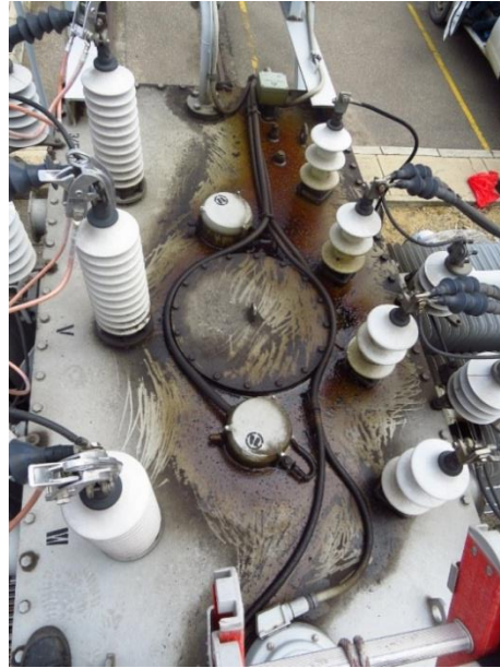
Figura 29. Fuga de aceite en un Transformador de potencia. Subestación Iraka.
