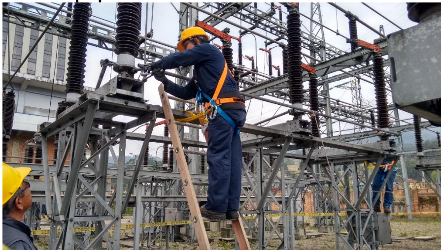
Figura 56. Calibración de un seccionador de barras. Subestación Termopaipa
