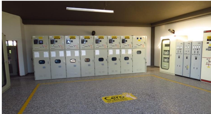
Figura 6. Subestación Higueras, Duitama, tipo capsulada, media tensión
