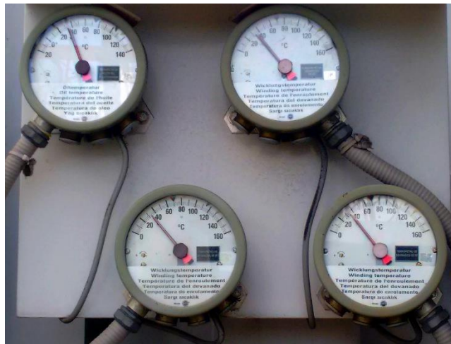
Figura 36. Indicadores de temperatura de aceite y de temperatura de devanados. Transformador tridevanado. Subestación Termopaipa
