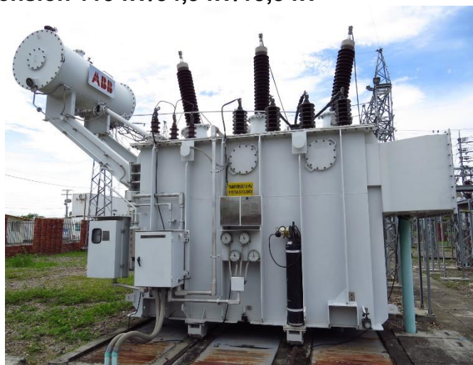
Figura 11. Transformador tridevanado, subestación Puerto Boyacá, niveles de tensión 115 kV/34,5 kV/13,8 kV
