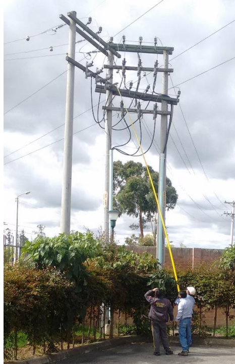
Figura 58. Maniobras en el pórtico por parte de personal EBSA
