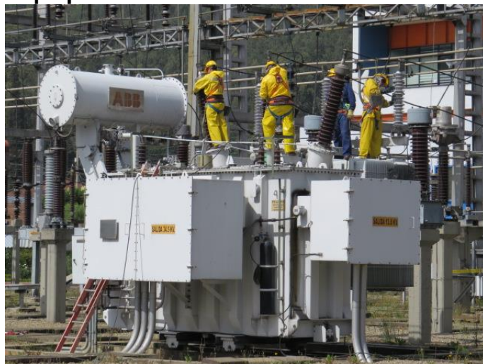
Figura 33. Limpieza general al transformador tridevanado. Subestación Termopaipa
