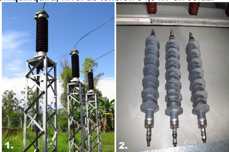
Figura 17. 1. Pararrayos cerámico, subestación Guateque, nivel de tensión 115 kV en patio. 2. Pararrayos polimérico, subestación Chiquinquirá, nivel de tensión 34,5 kV en celda.
