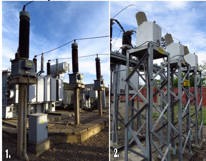
Figura 15. 1. Transformador de potencial, subestación San Antonio, nivel de tensión 115 kV. 2. Transformador de potencial, subestación Puerto de Boyacá, nivel de tensión 34,5 kV.
