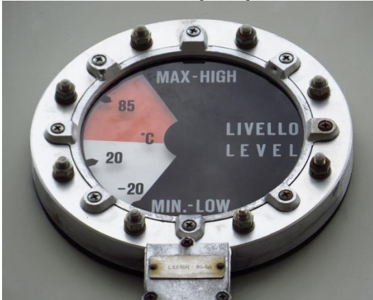
Figura 30. Medidor de aceite, tanque de expansión transformador de potencia. Subestación Chiquinquirá
