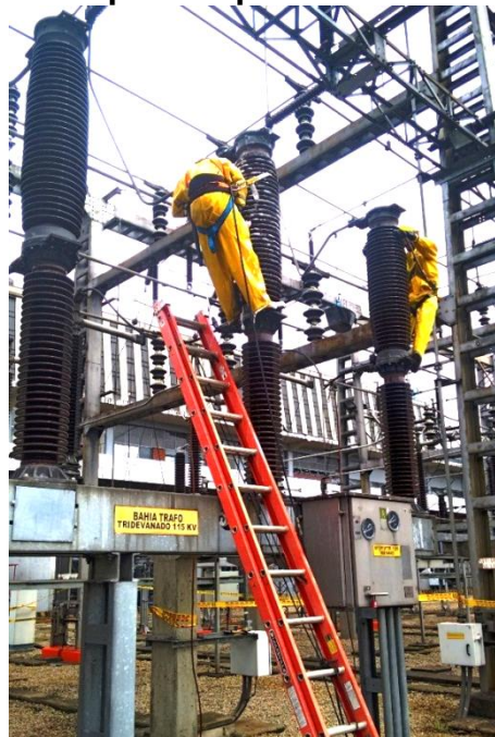
Figura 43. Limpieza a interruptor de potencia. Subestación termopaipa
