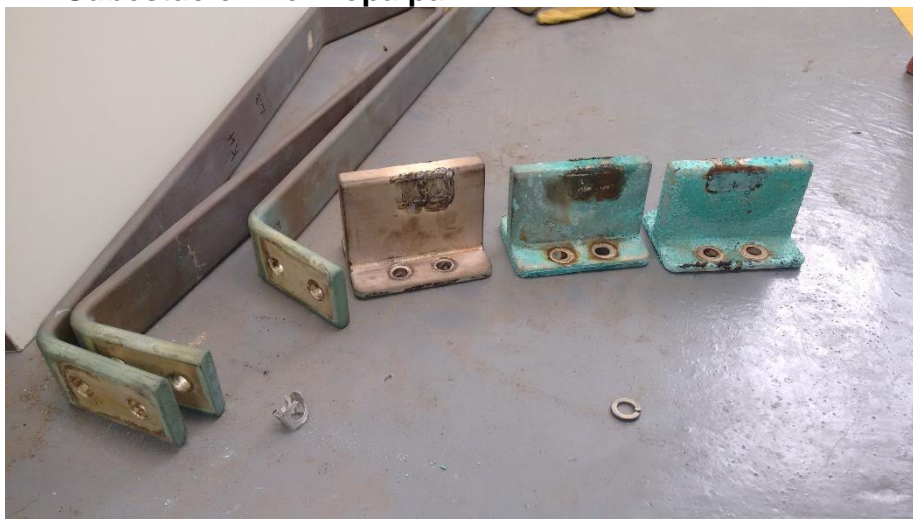
Figura 61. Corrosión excesiva en contactos de una celda de 13,8 kV. Subestación Termopaipa
