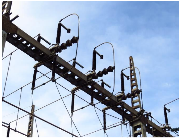
Figura 16. Seccionador de transferencia abierto (superior), seccionador de línea cerrado (inferior), subestación San Antonio, nivel de tensión 115 kV.
