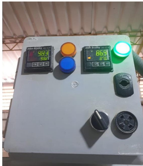
Imagen 21. Tablero monitoreo de temperatura y humedad nacedoras
