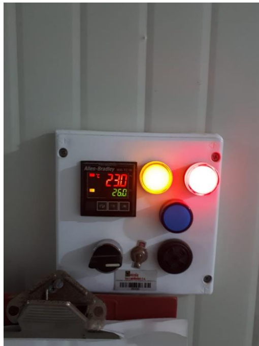
Imagen 15. Tablero monitoreo de temperatura cuarto de precalentamiento
