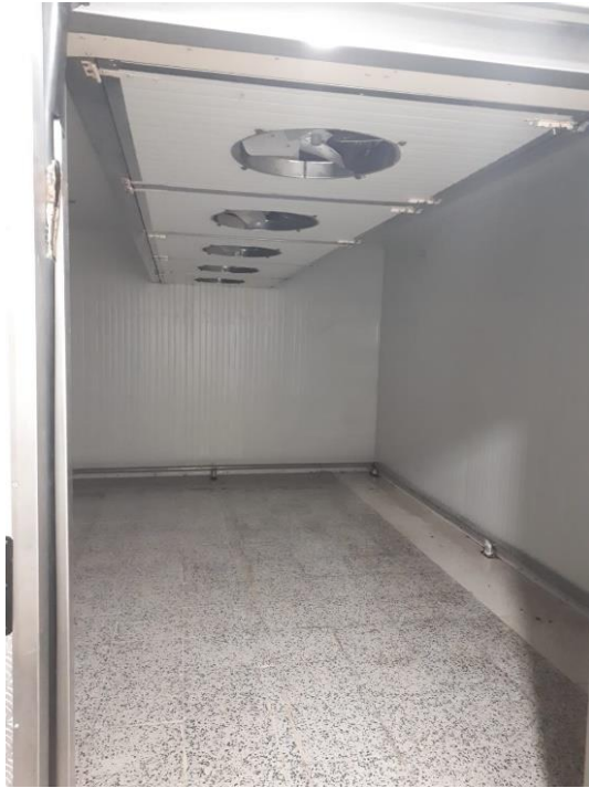
Imagen 14. Cuarto de precalentamiento
