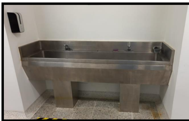
Imagen 20 Lavamanos quirófanos del HVUT
