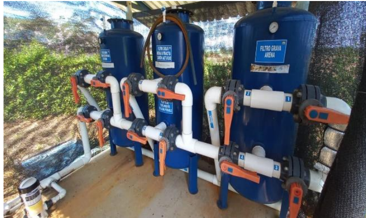
Ilustración 26.- Tanques de tratamiento. (autor, 2021)
