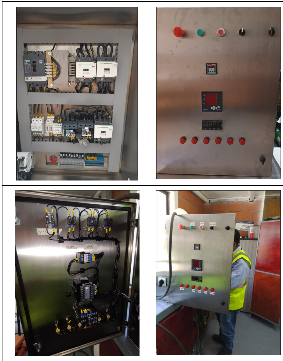
Figura 27. Resultado tablero eléctrico.
