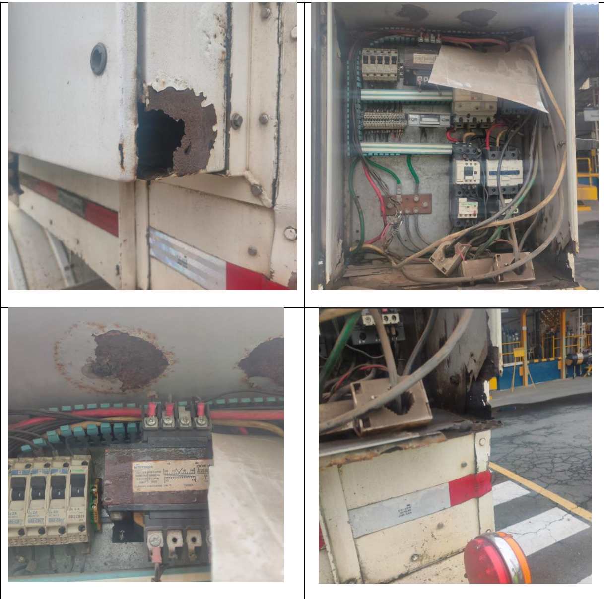
Figura 24. Estado interior gabinete tanquero 11006
