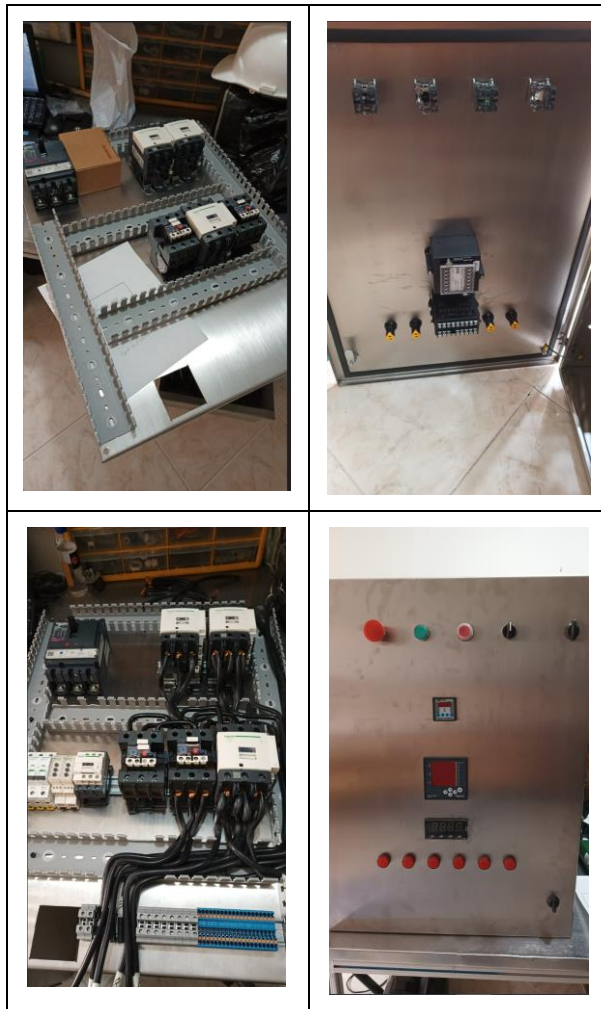
Figura 25. Posicionamiento de materiales de potencia y control.
