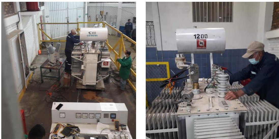
Ilustración 29. Pruebas piloto a transformador PCH
