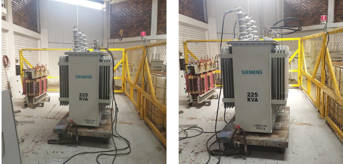
Ilustración 31. Pruebas piloto a transformador de 225 KVA
