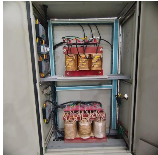
Ilustración 28. Tablero de transformadores T-TRF
