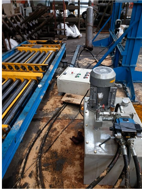
Ensayo de unidad hidráulica eléctrica y mecánica.
