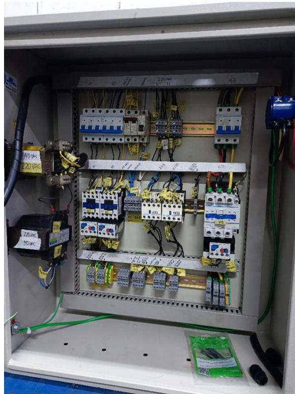
Figura 5. Tablero eléctrico formadora ASC
