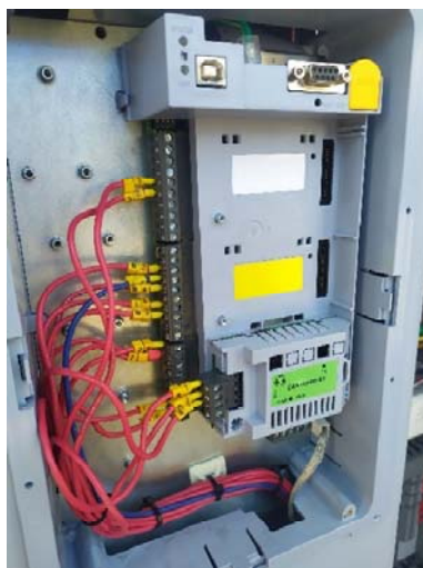
Figura 61. Gateway de comunicación CAN / RS-485 de variador de frecuencia WEG
