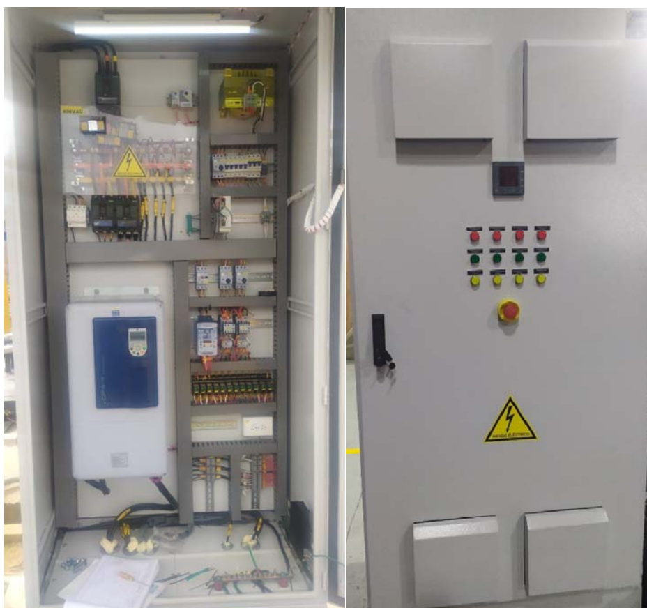
Figura 69. Tablero de potencia de unidad recuperadora de vapores
