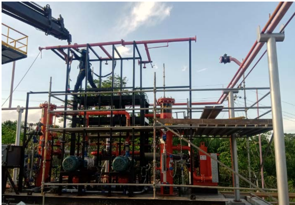
Figura 5. Unidad recuperadora de vapores
