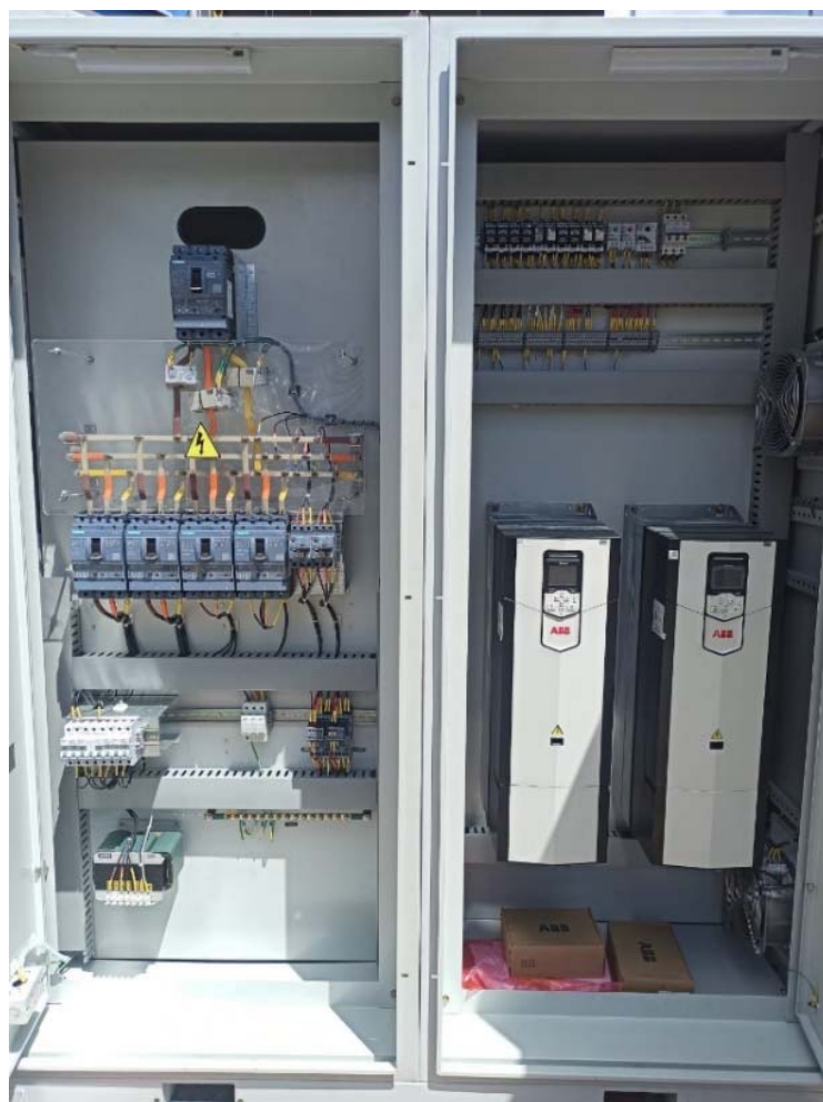
Figura 12. Tablero CCM de baja tensión
